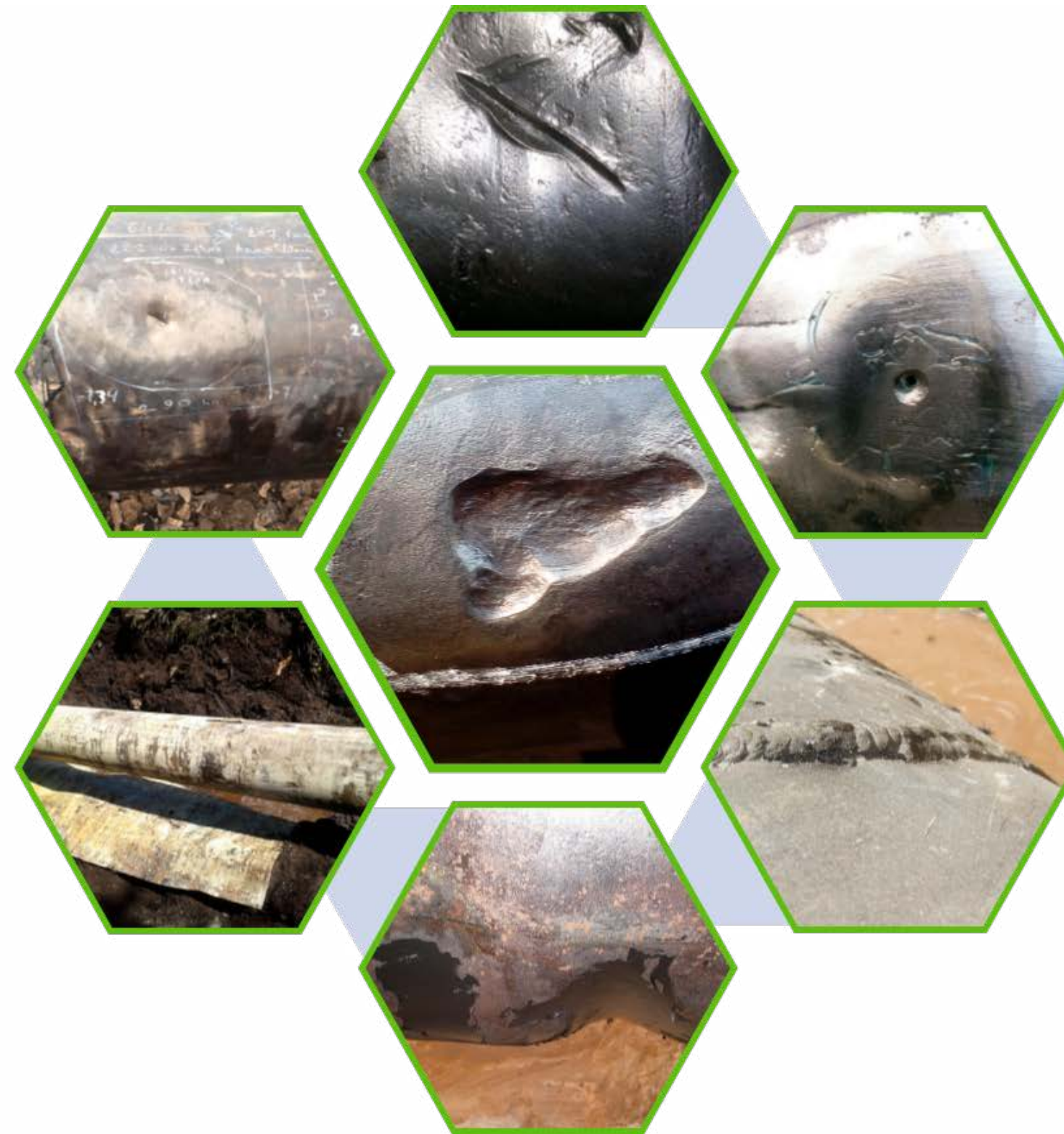
7. attēls. Pārvades sistēmas defektu piemēri
